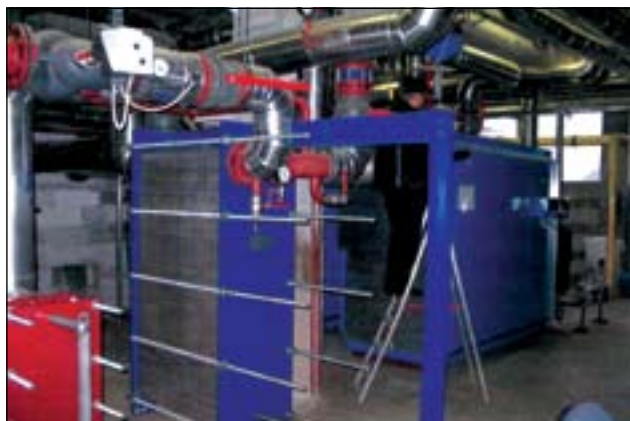
Ploščni prenosnik toplote in rezervni plinski kotel
